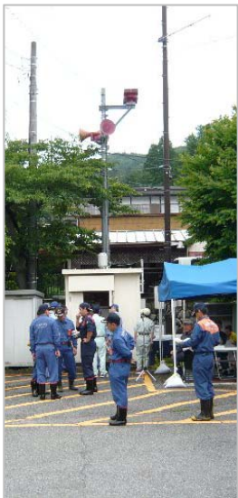
土石流予警報装置
