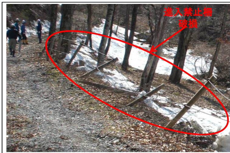
進入禁止柵破損
