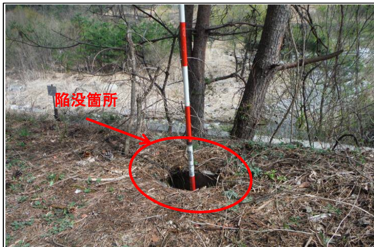
擁壁背面に陥没箇所
