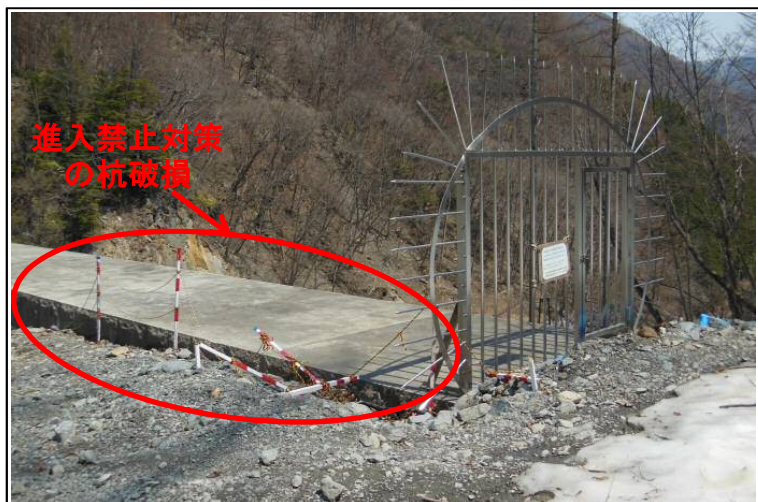
砂防堰堤の天端進入防止対策用杭破損
