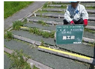
点検時の状況
