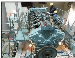
排水機場の保守・点検
