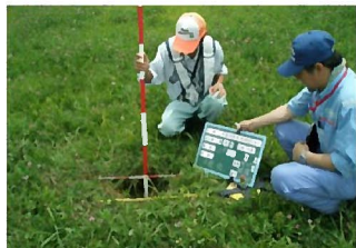
堤防陥没箇所の測定状況
