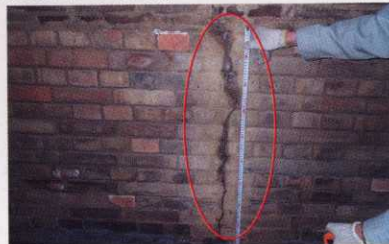
▲老朽化している樋管の内部
