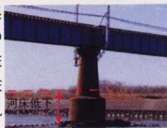
▲河床が低下している JR水戸線鬼怒川橋梁
