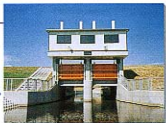
新設された排水設備 (下館市の横島上水排水設備新設工事)
