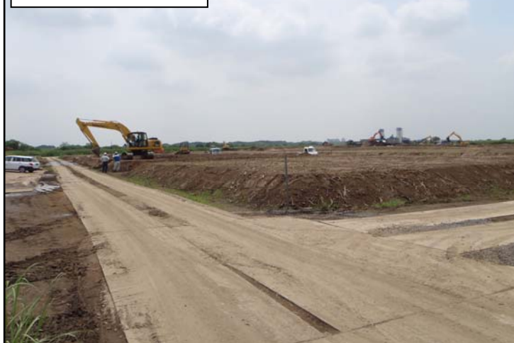
曝気ヤードの状況
