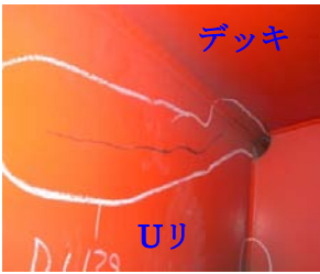
図-9 損傷状況 A
