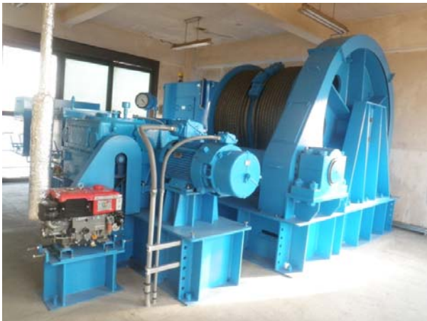
写真3. 岩淵水門巻き上げ機室内写真
