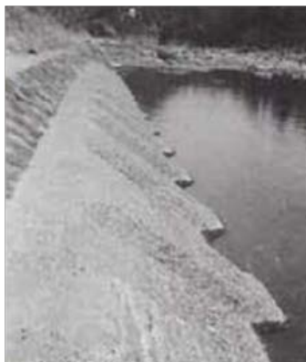
中和前の河川水により劣化した護岸コンクリート
