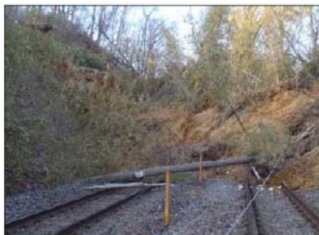
写真 1-22 JR東北線豊原駅～白坂駅間（栃木県那須町）切取崩壊
