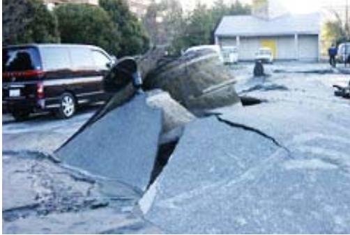
写真 1－4 液状化によってせり上がったマンホール
