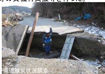
県道被災状況調査
