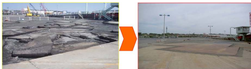
写真 1-17 茨城港大洗港区第 3 ふ頭地区における液状化による被災
