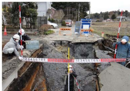
写真 1-30 栃木県市貝町 管路の損壊と道路陥没
