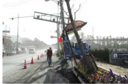
写真 1－5 液状化によって傾いたバス停
