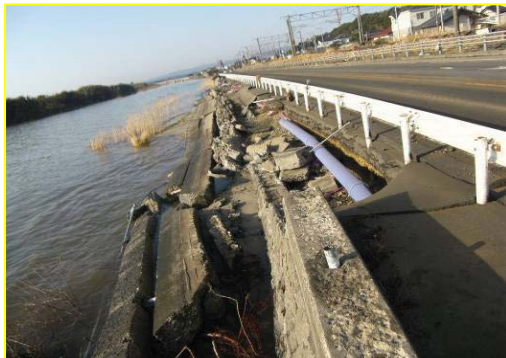
写真 1-11 国道 6 号（北茨城市磯原町）擁壁倒壊
