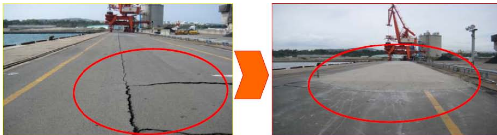
写真 1-15 茨城港日立港区エプロンと背後との段差（第 1 ふ頭地区 D 岸壁）
