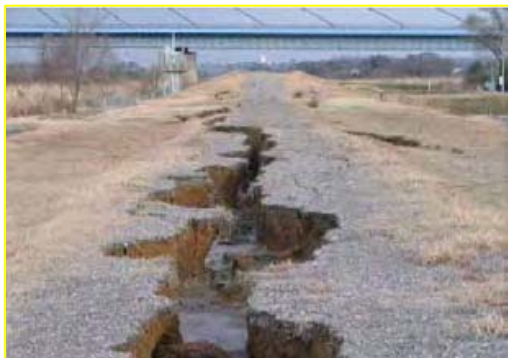
写真 1－7 那珂川（水戸市下大野地先）堤防亀裂 L=650m
