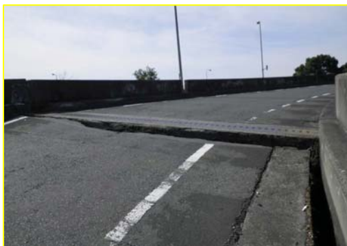
写真 1-14 国道 357 号（浦安市）路面段差
