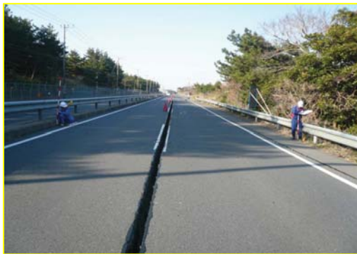
写真 1-12 国道 51 号（大洗町成田）路面段差
