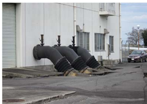
写真 1-28 茨城県稲敷市 地盤沈下した用水機場
