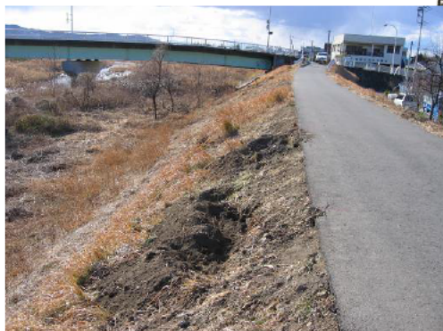
イノシシに荒らされた堤防法面
