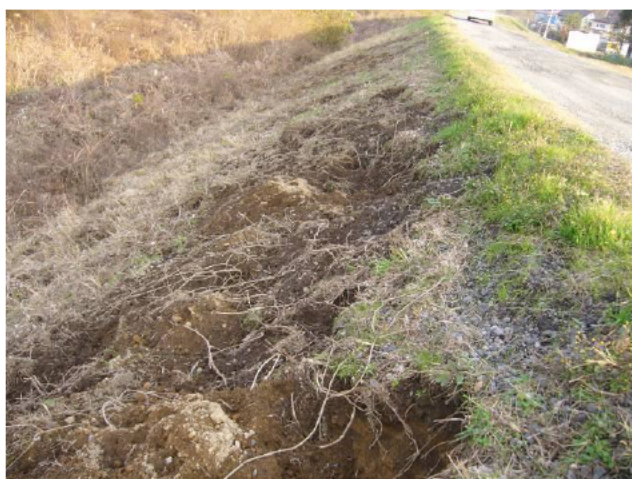
イノシシに荒らされた堤防法面
