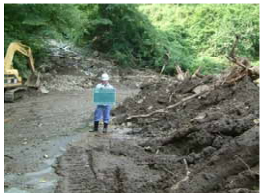
＜国道１８号（県管理）：土砂流出＞
