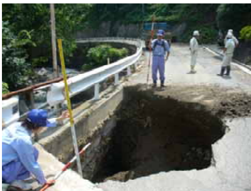
＜県道 ほしおはざわ 星尾羽沢線：路面陥没＞
