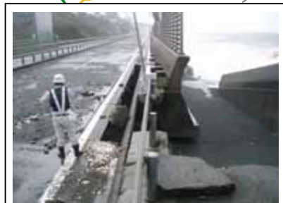
① 擁壁破損
