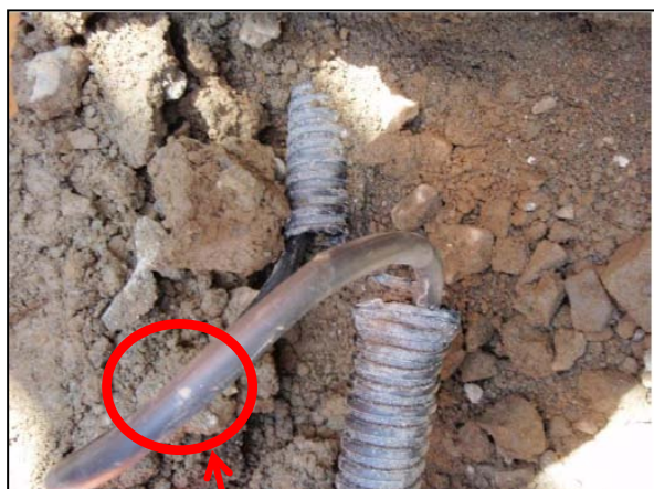
道路照明灯電源ケーブル損傷状況
