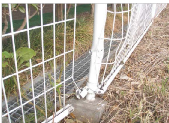
フェンス損傷状況
