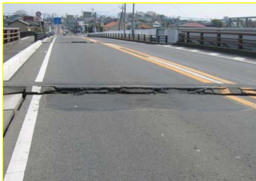
写真 1－13 国道 50 号（筑西市）橋梁段差
