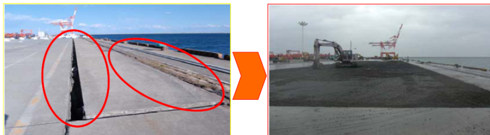
写真 1-16 茨城港〔常陸那珂港区〕エプロン陥没、段差（北ふ頭地区 C岸壁）
