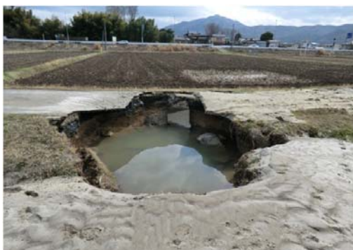
写真 1-27 茨城県桜川市 管の破損による漏水
