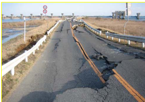
写真 1－9 利根川（神栖市横瀬地先）堤防陥没 L=389m
