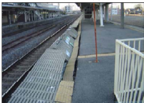
写真 1-19 JR常磐線石岡駅（茨城県石岡市）乗降場損壊
