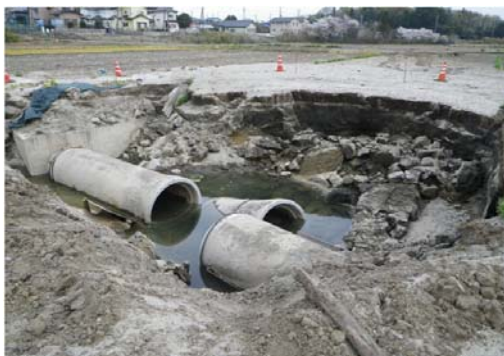
写真 1-25 茨城県古河市 脱落した管
