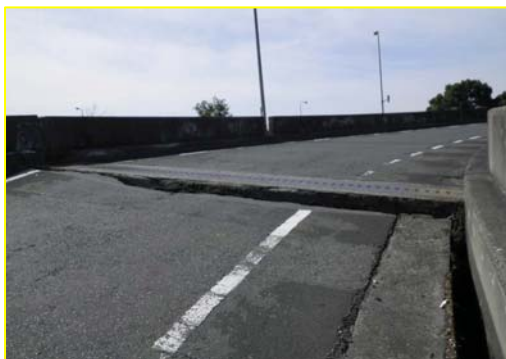
写真 1－14 国道 357 号（浦安市）路面段差
