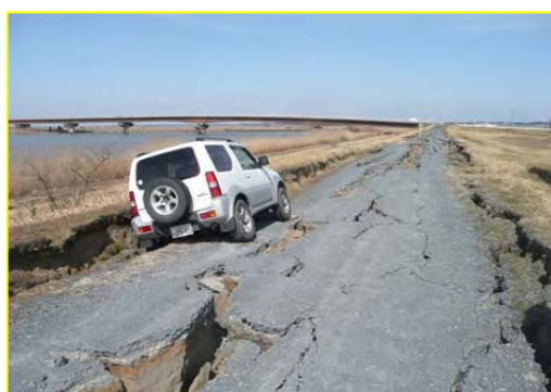
写真 1－8 常陸利根川（稲敷市本新地先）堤防沈下・亀裂 L=1,480m
