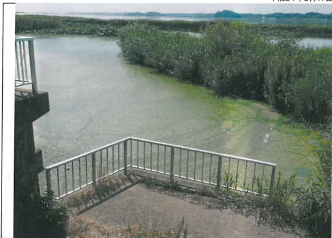
西浦左岸34km—100上高崎排水樋門前 レベル5～6 におい有り
