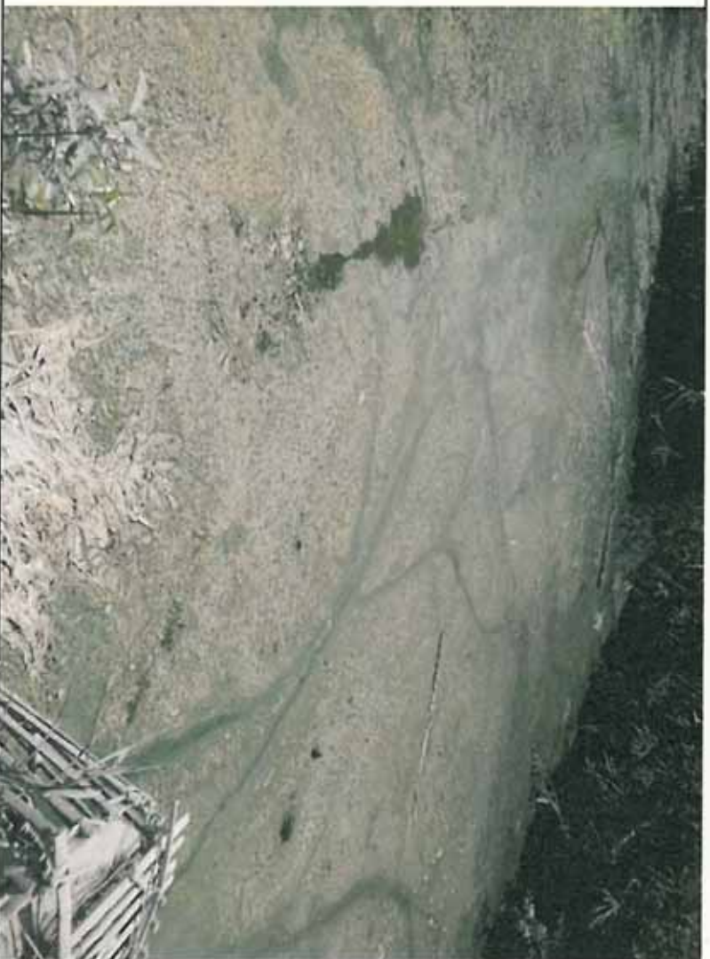
西浦左岸34.25km+100浄化施設内
