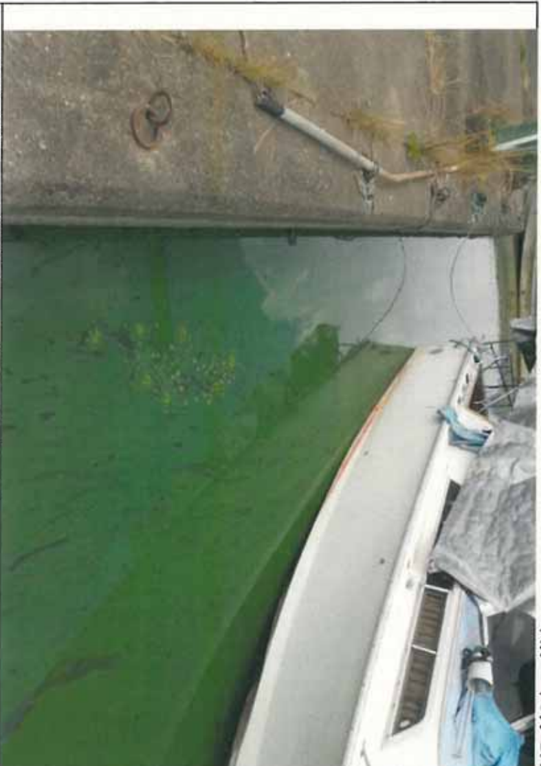
西浦左岸32.5km下高崎舟溜り レベル3～4にৌい有り
