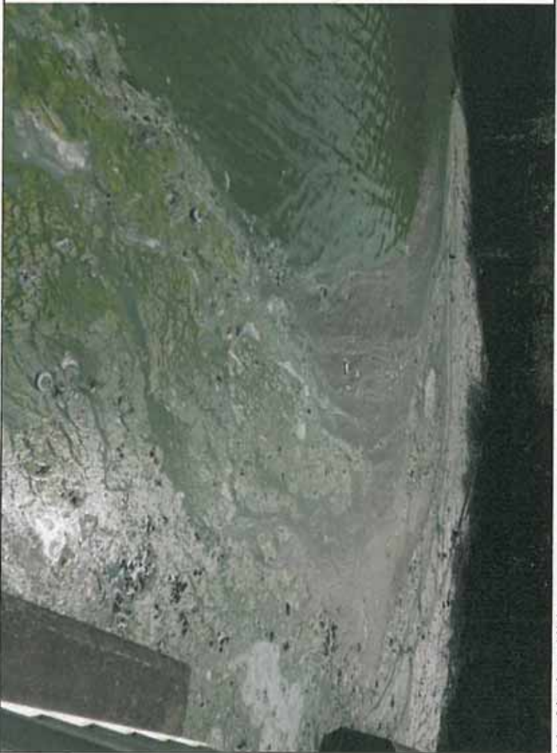
西浦左岸34km-100 上高崎揚排水樋門前 レベル4~5 におい有り
