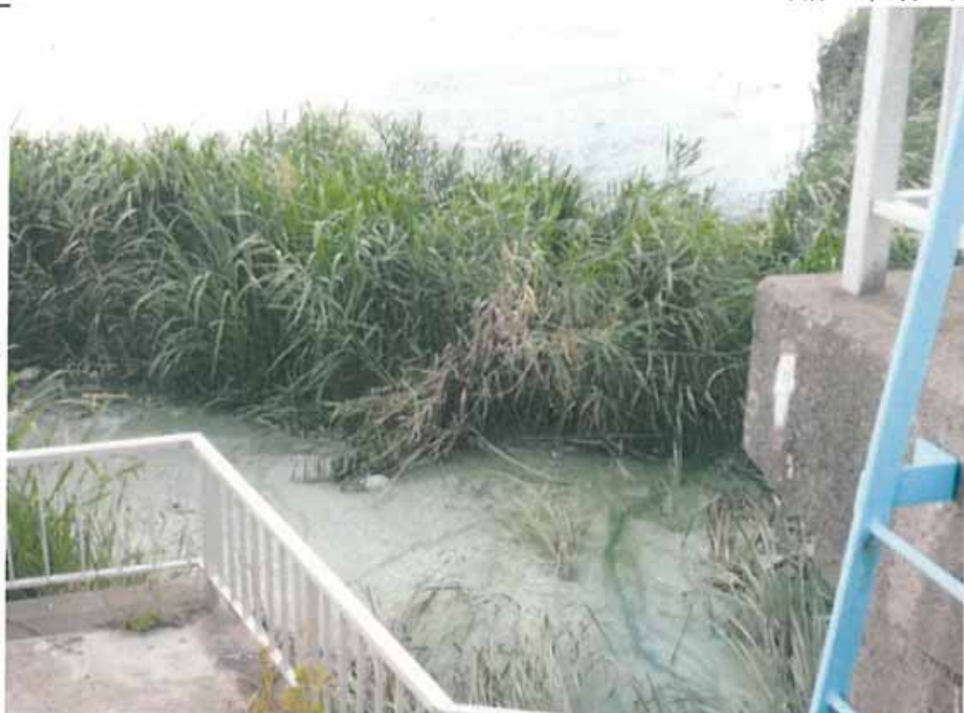
西浦左岸34km+140川島排水樋門前 レベル6 におい有り(湖面最大値)
