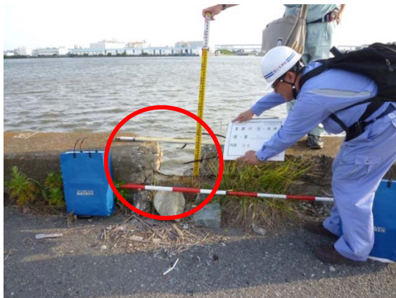
護岸の破損を確認。
