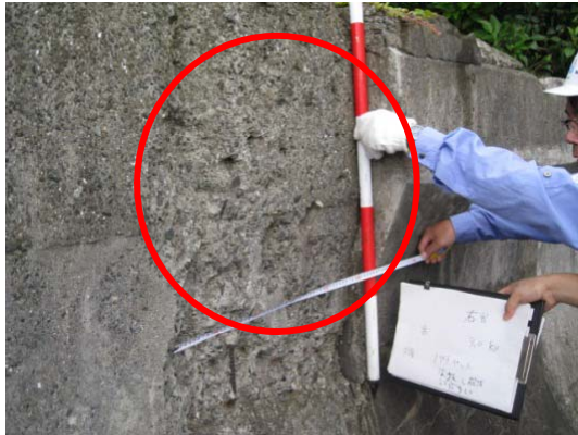
堤防護岸の表面が劣化して破損を確認。
