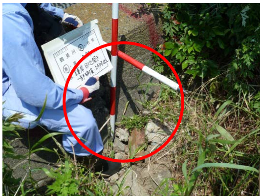
護岸の裏側の土の吸い出しを確認。
