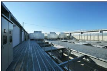
第三庁舎 RF:熱源機置場
