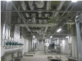
第三庁舎 B1F:空調機械室
