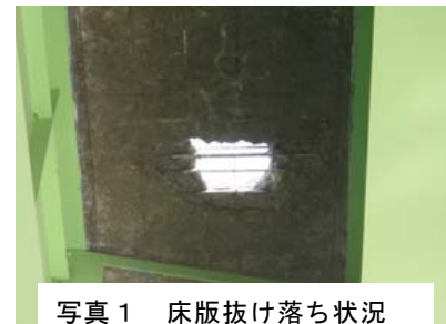
写真1 床版抜け落ち状況
