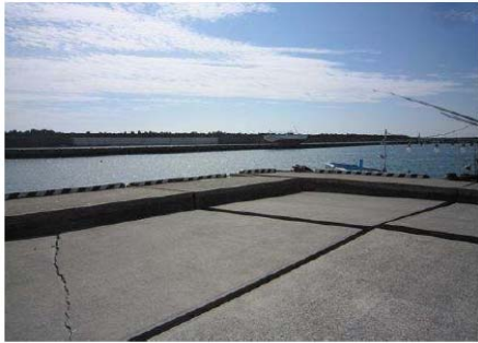
茨城大学調査報告（その4）2011/3/20 那珂湊港、海門町
