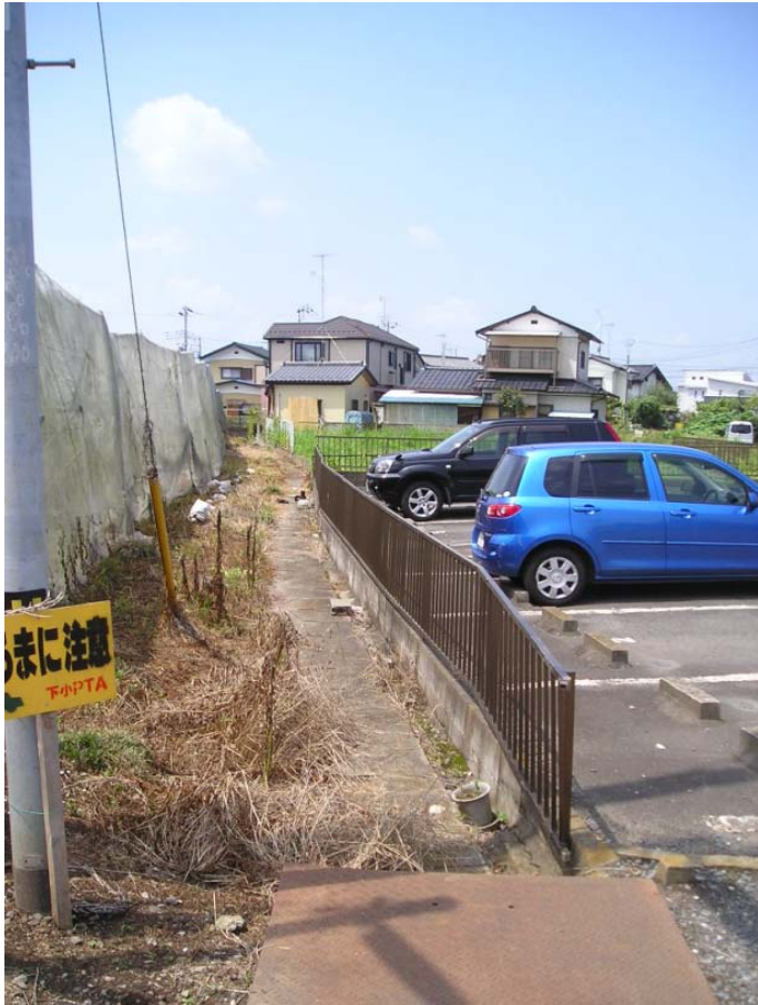
隣接する駐車場境界部の変状
