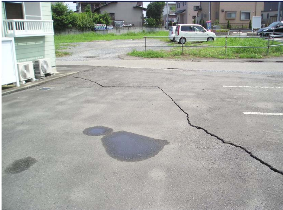
粕田金一（基礎地盤コンサルタンツ株）2011/7/25 隣接する駐車場の亀裂
