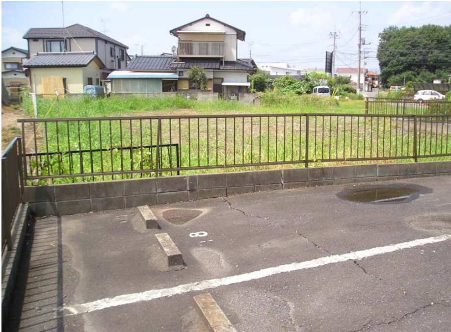
隣接する駐車場の亀裂と取り壊し後の空き地
