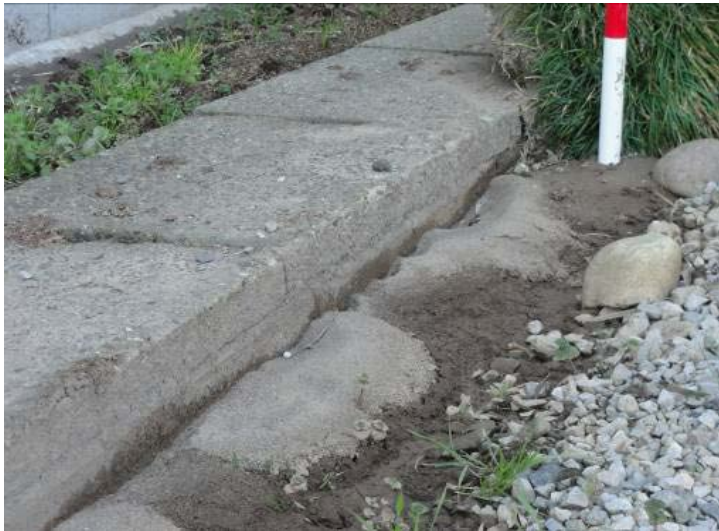
利根川下流河川事務所(右岸 新川排水機場近く)
