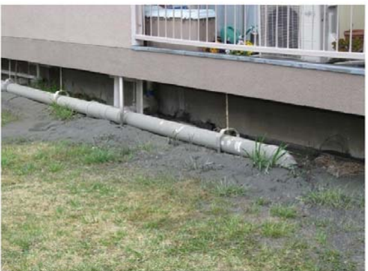
団地基礎部分:配管が浮動したため、応急処置を行っている
