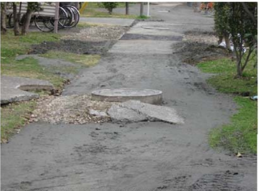
マンホール部分が飛び出ている:これは、液状化により周囲が沈下したため
