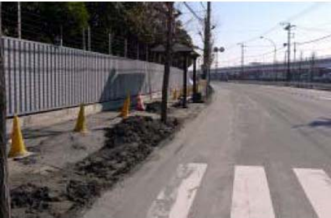
この地域では水道管の敷設替えをした場所で激しい液状化が見られた。歩道には大量の噴砂が寄せられている。工事の看板が出ていたため埋め戻しを行って間もない可能性がある。
