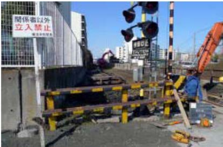
これは神奈川臨海鉄道の線路である。液状化によって地盤が沈下してしまい、線路が浮いた状態になっていた。そのため、応急復旧している。
