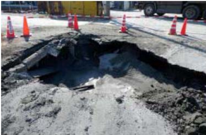
これは水道管の接続部が外れたことによるものである。大きく陥没している
