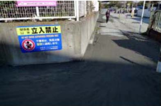
集合住宅の海側で液状化している。噴砂が流れ出た様子が分かる。
