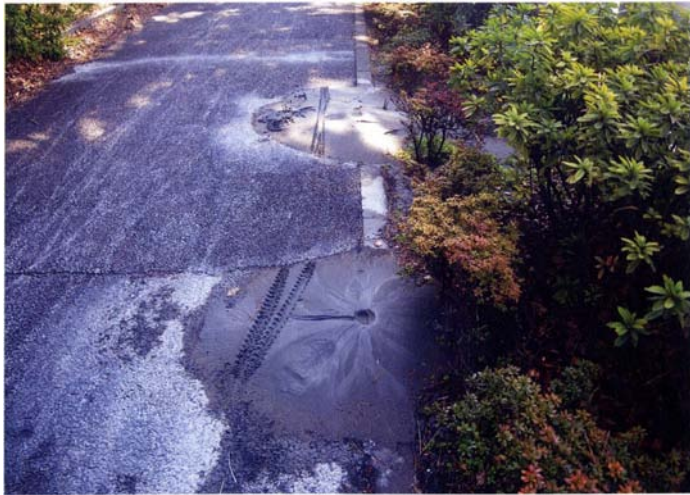
東京港における液状化(噴砂)の発生状況 (東京都港湾局)
