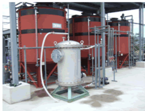
■工場の排水処理施設の事例
