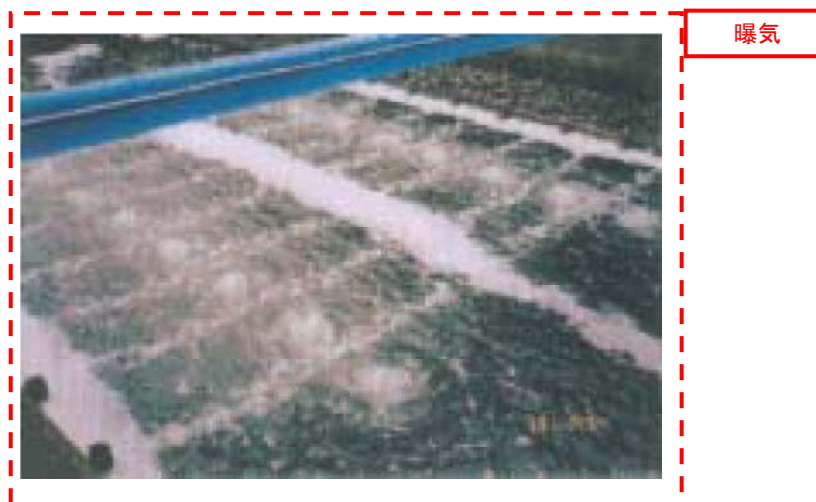
曝気装置稼働状況
