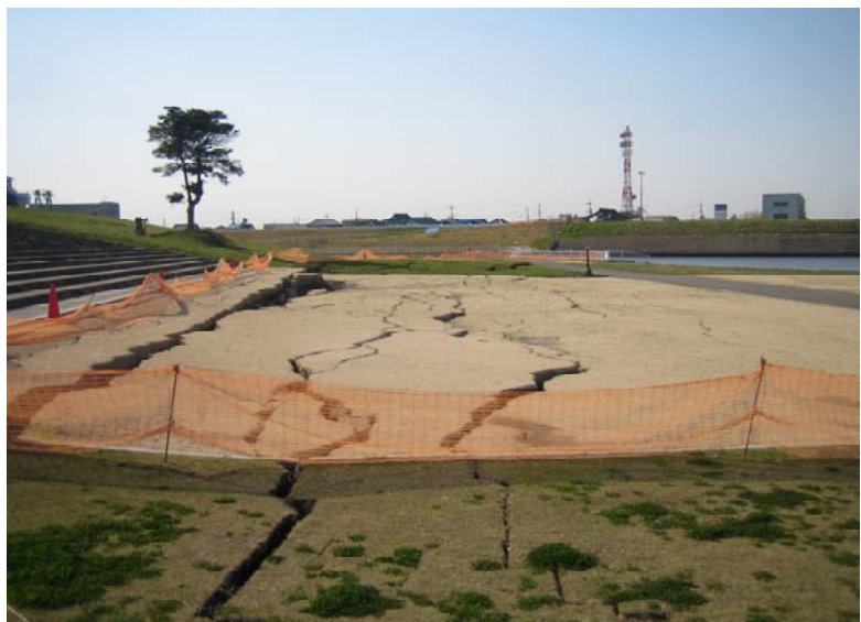
水の郷さわら地震による被災の様子
