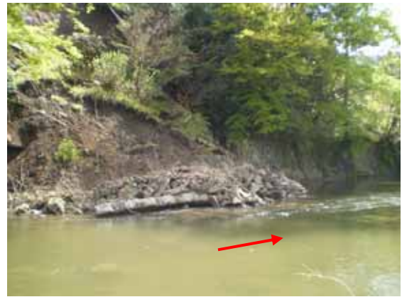
一級河川里川 被害状況 (常陸太田市上深萩町地先)
