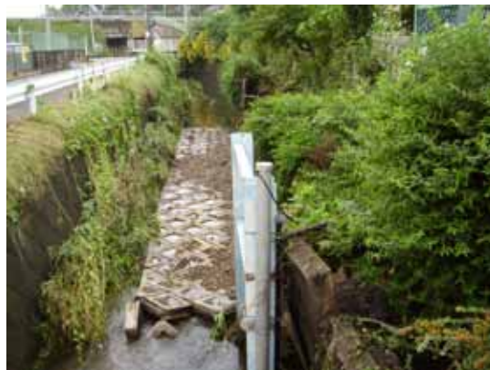
河川施設被災状況（所沢市：東川）
