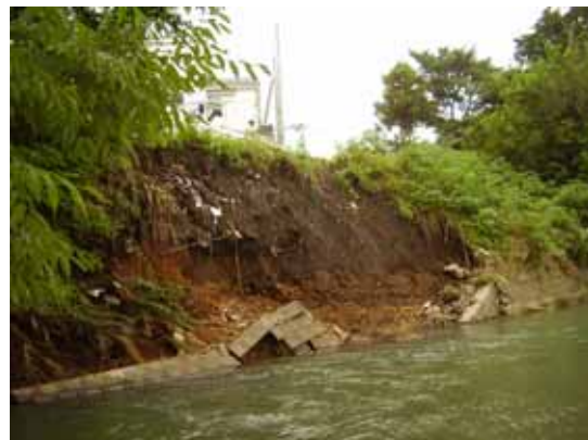
河川施設被災状況（所沢市：柳瀬川）
