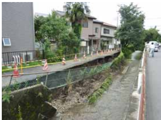
河川施設被災状況（所沢市：東川）
