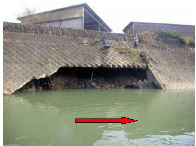
加茂川（鴨川市北小町地先）左岸側の崩壊状況
