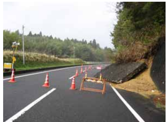
国道293号 被害状況 (常陸太田市大平町地内)
