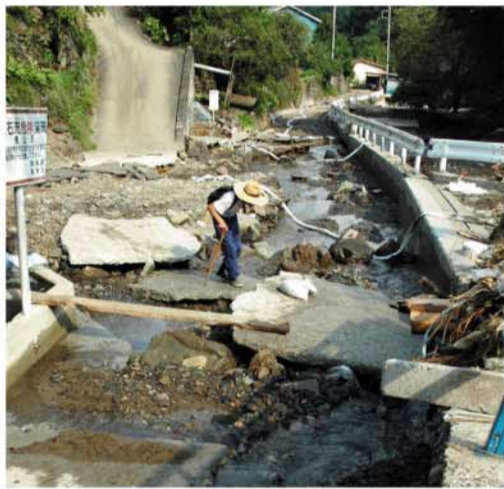
台風9号の影響で崩壊した道路(南牧村)
