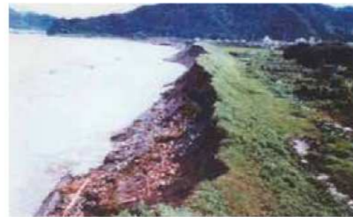
堤防の侵食(昭和57年)
