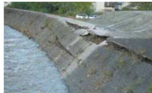
岩間地先護岸の崩落(平成16年)
