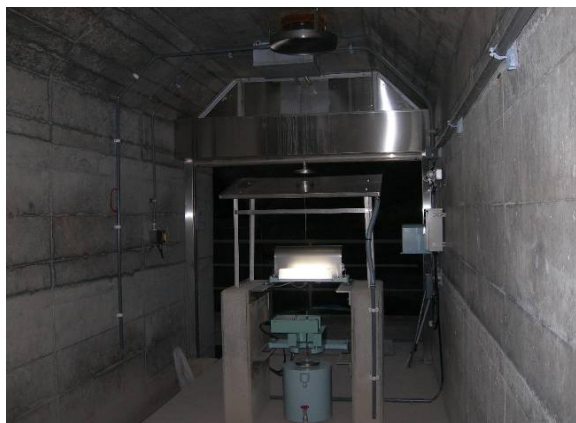
プラムライン計測設備
