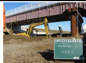
渡河橋への接触防止対策
