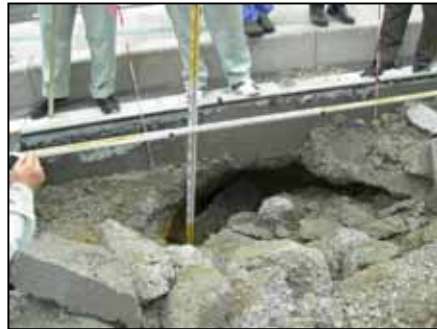
中央分離帯付近の空洞
