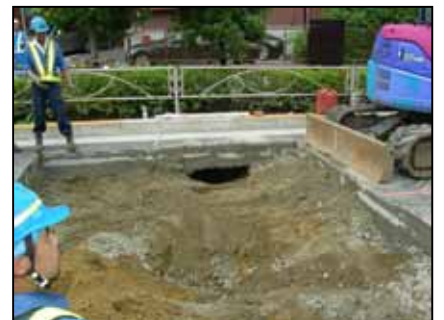
歩車道境界付近の空洞
