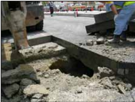
8月4日現地調査時に確認した空洞
