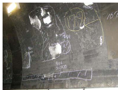
【トンネル損傷】
