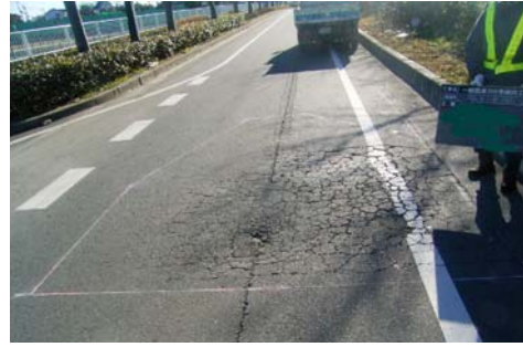
<路面異常確認>
