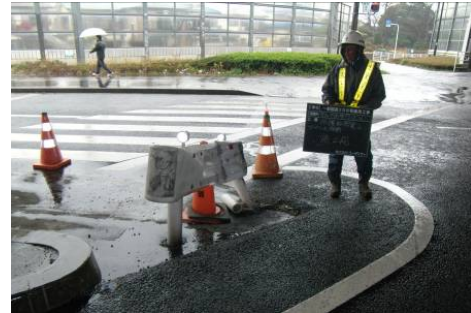
<ガードレール損傷確認>
