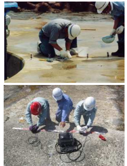
コンクリート護岸ひび割れ補修・点検
