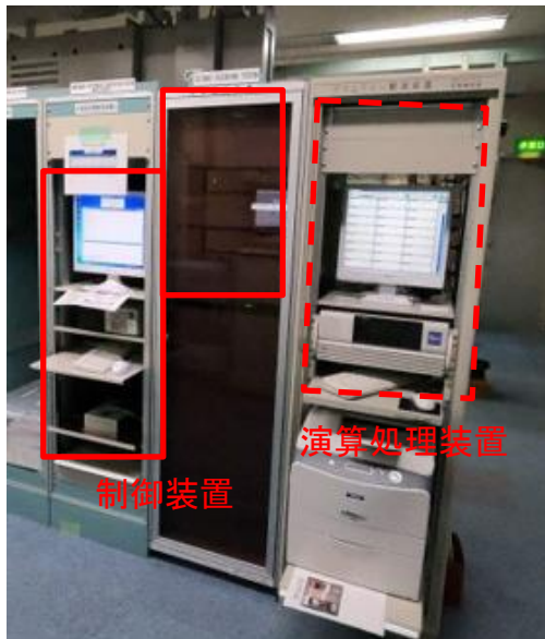
川治ダム堤体観測設備（演算処理装置） 地震観測設備（制御装置）
