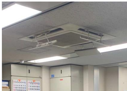
庁舎1階室内機状況
