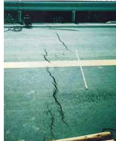
国道462号に 発生した亀裂
