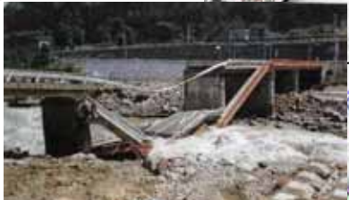
三原橋の落橋 (昭和56年)
