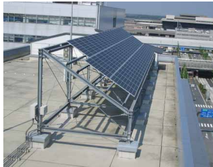
屋上太陽光パネル
