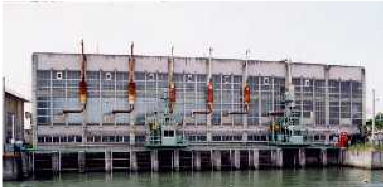
糠田排水機場の老朽化状況
