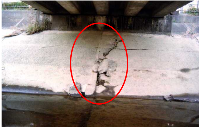
ライニングパネル損傷状況 (8,885m並木橋左岸下)
