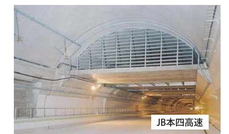
電気集じん機室の例
