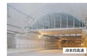
電気集じん機室の例
