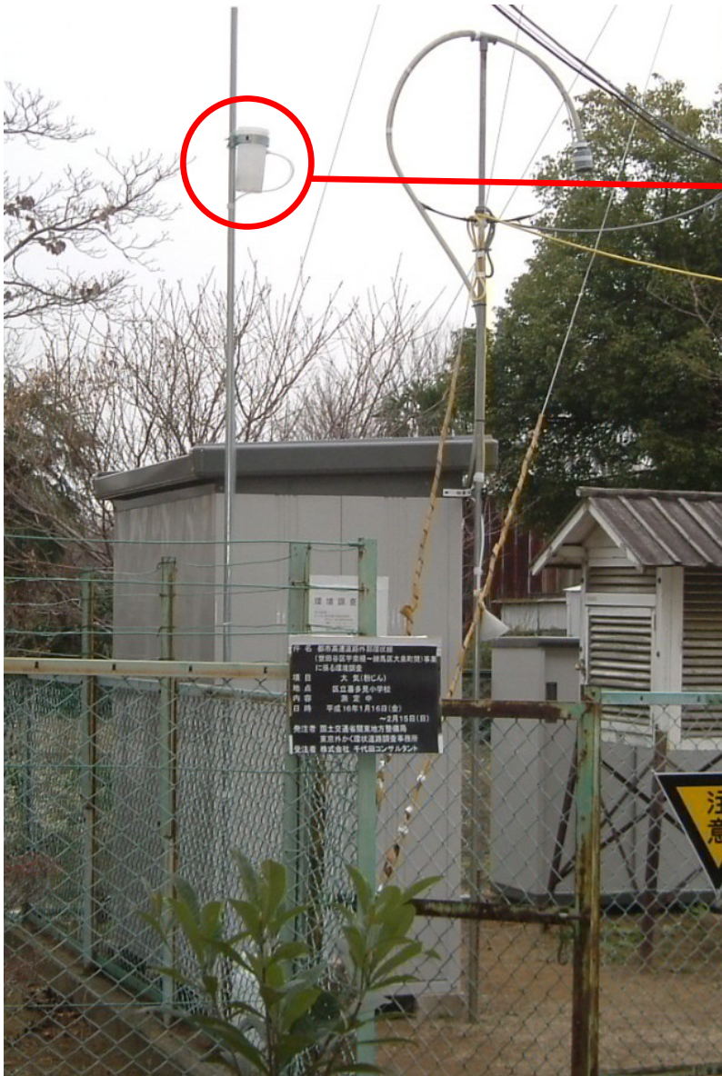
観測機器の設置(喜多見小学校)
