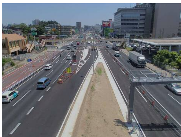
【完成】国道357号 千葉市中央区登戸5丁目地先 (東京方面から木更津方面を望む)
