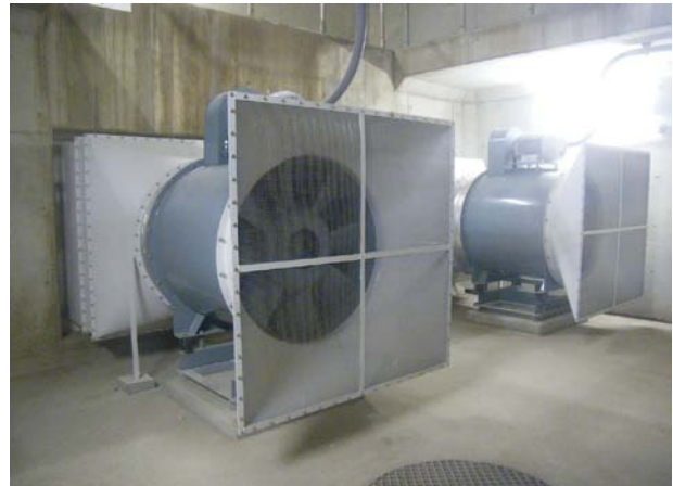
国道357号 千葉市中央区塩田町地先 (立坑内換気設備設置状況)
