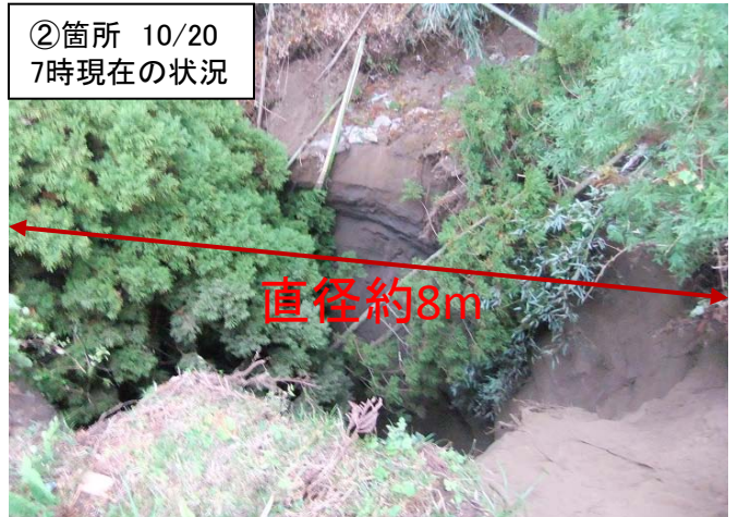
直径約8m 陥没深さ10m以上
