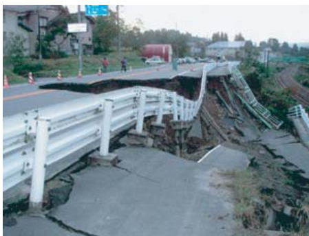
国道17号川口町天納 道路崩壊
